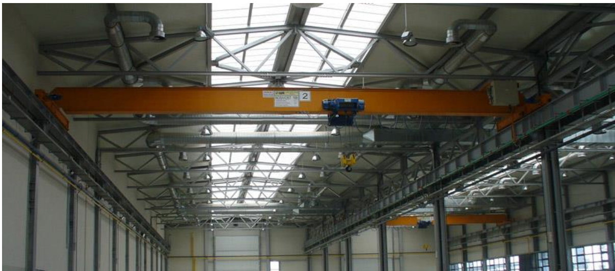
Slika 1.1-Jednogredna mostovska dizalica nosivosti 10 t, raspona 15.2 m
