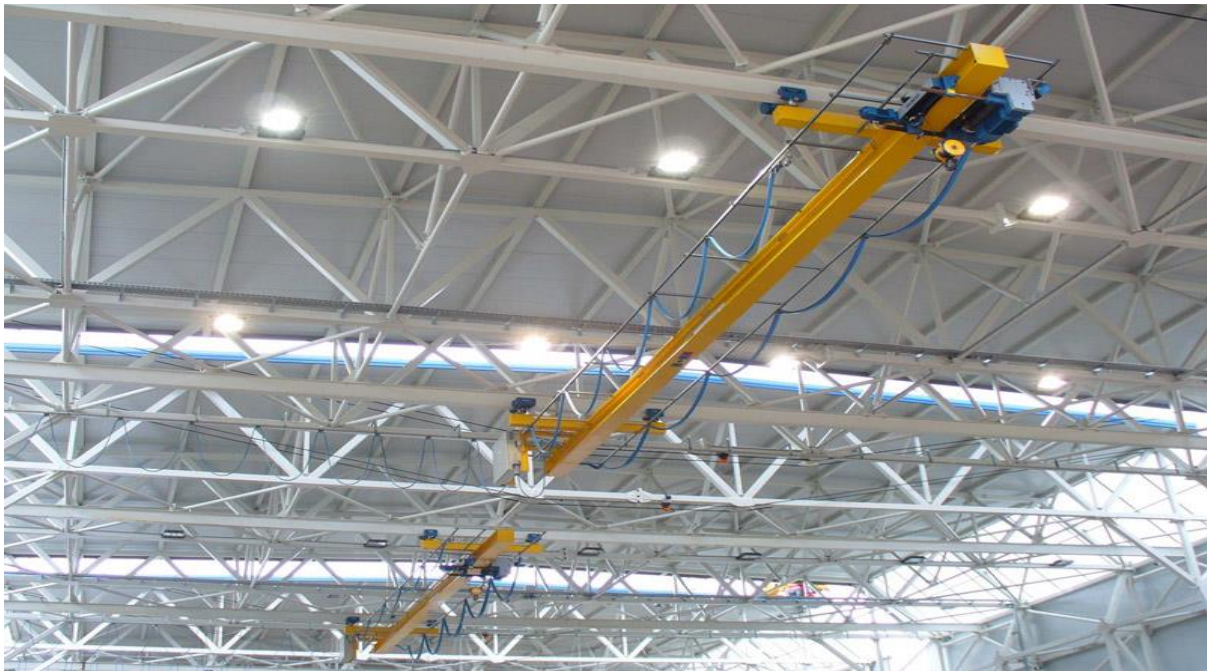
Slika 1.3-Viseća mostovska dizalica nosivosti 3.2 t, raspona 9.32 m
