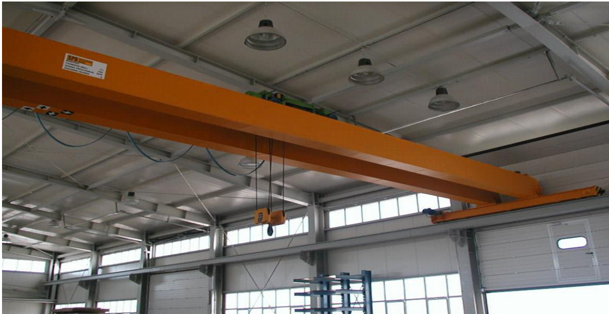
Slika 1.2-Dvogredna mostovska dizalica nosivosti 5 t, raspona 19.15 m
